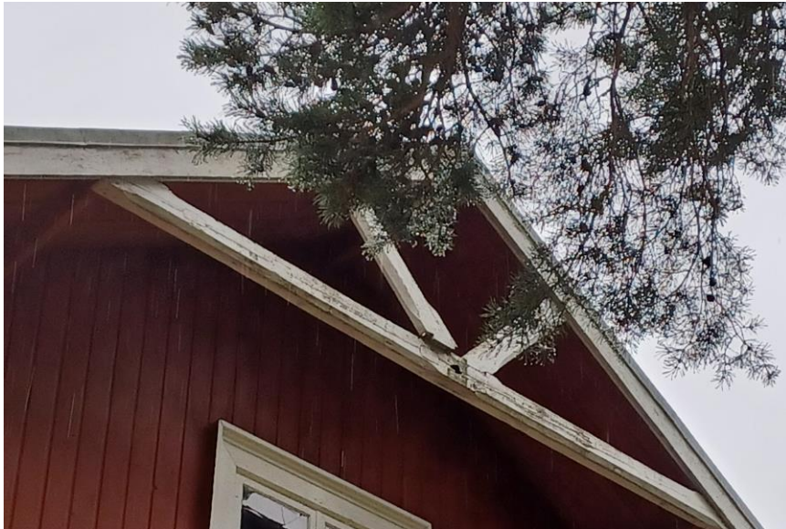
Norra gaveln: Skadade snickerier.
