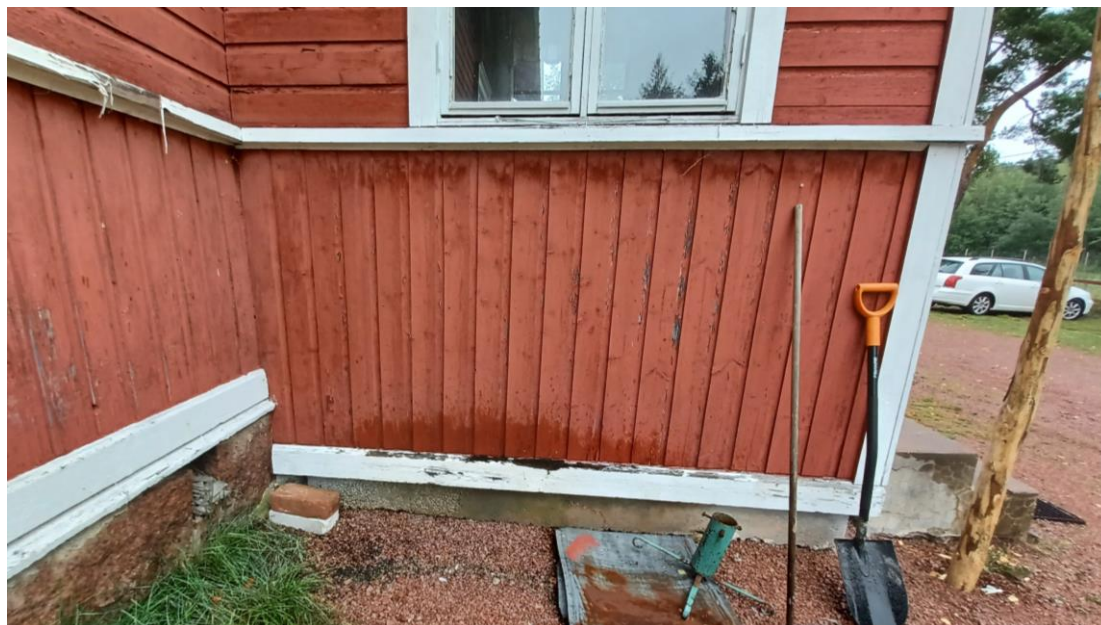
Fasad mot öst: Flagande färg och rötskadad sockelbräda.
