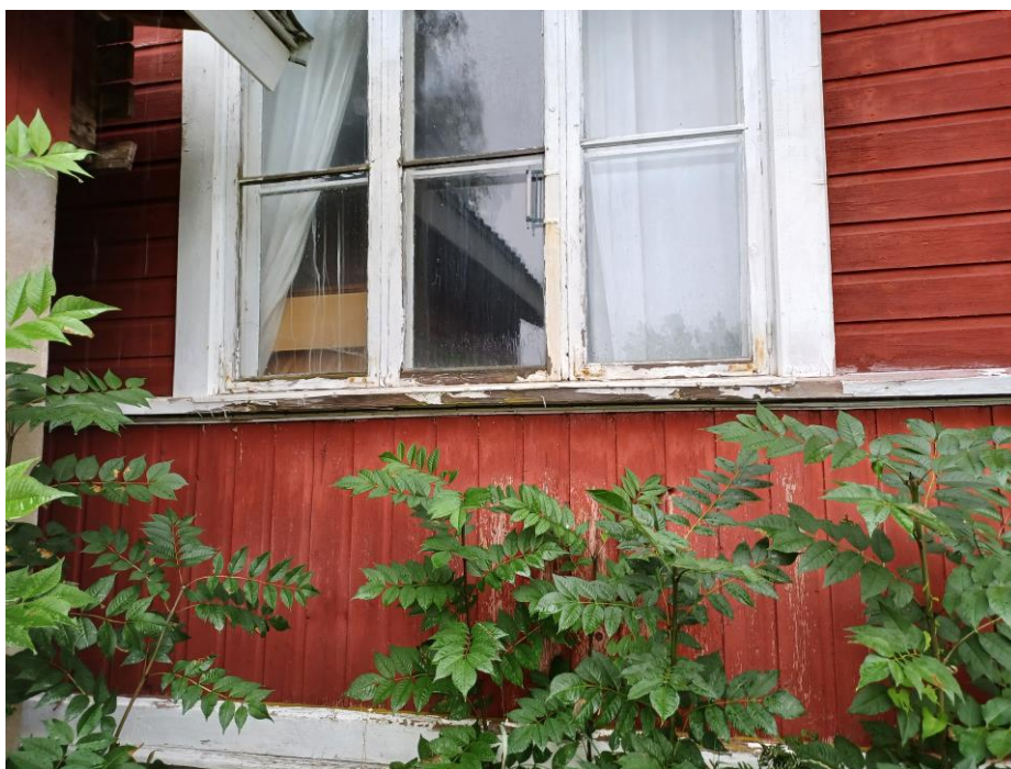
Skador pga rinnande och stänkande vatten vid pannrummet på västsidan
