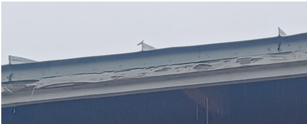
Takfot mot öst: Flagande färg på hängbräden.
